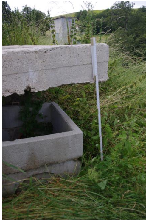
Foto 1 – Cedimenti spigolo Nord-Ovest
