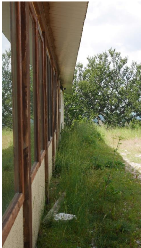
Foto 12 Inclinazione della parete Nord
