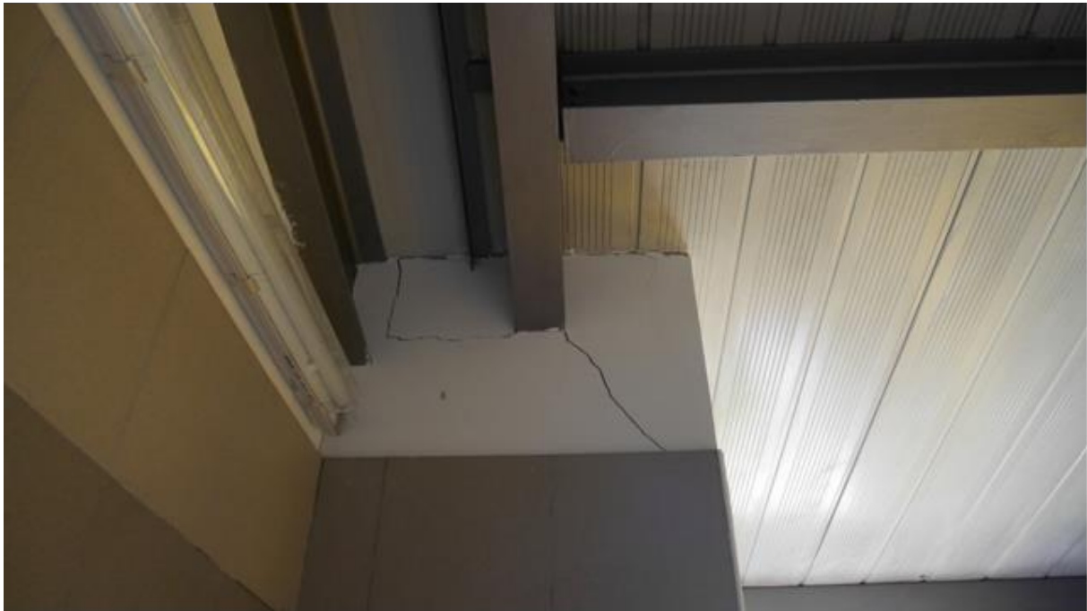
Foto 9 – Collegamento tra “Edificio A” e “Edificio B” Quadro fessurativo in prossimità di ciò che dovrebbe essere un giunto (A destra “Edificio A”)
