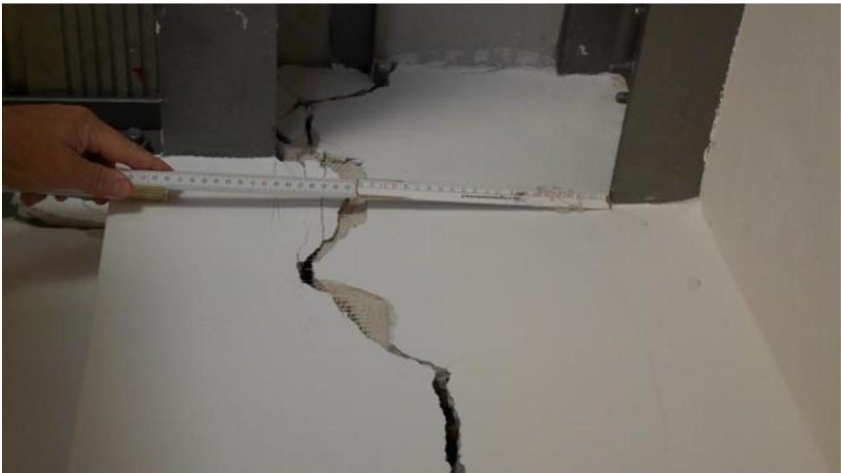
Foto 8 – Collegamento tra “Edificio A” e “Edificio B” Quadro fessurativo in prossimità di ciò che dovrebbe essere un giunto (A sinistra “Edificio A” Particolare)
