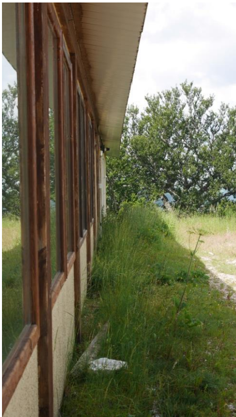
Foto 12 Inclinazione della parete Nord
