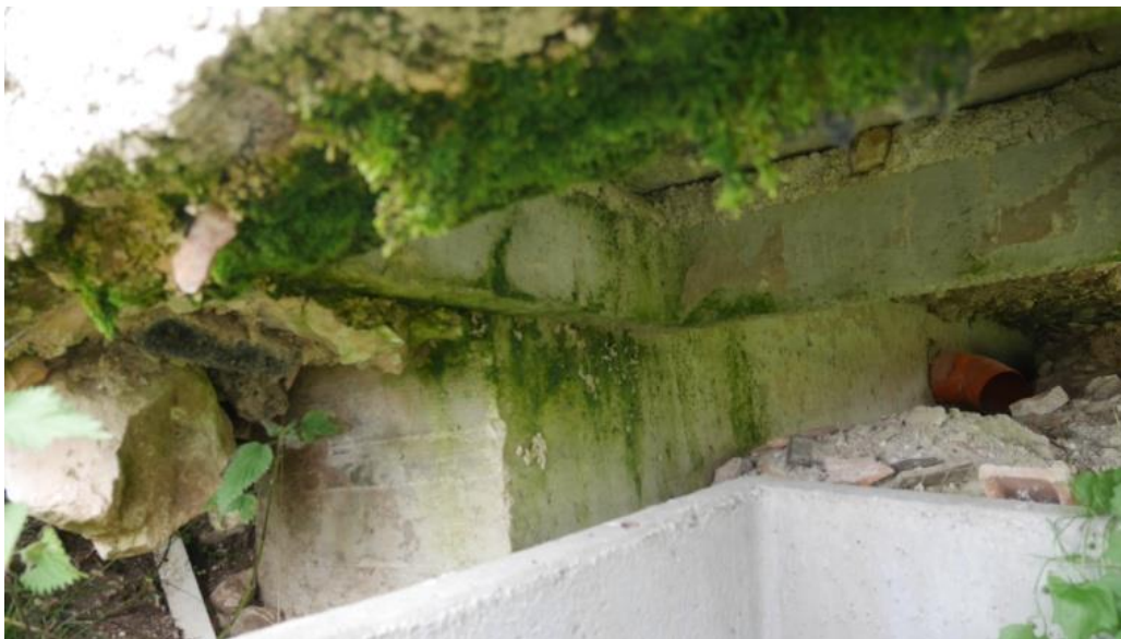
Foto 16 – Trave in calcestruzzo armato di fondazione ed evidente abbassamento del riporto costituente la base fondale e la scarpata Nord-Ovest
