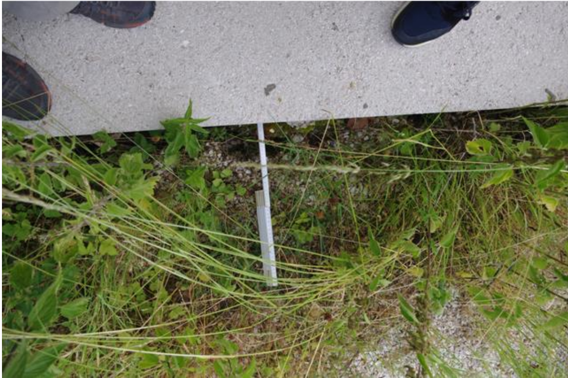
Foto 3 – Particolare della entità dei fenomeni di cedimenti differenziali angolo Nord-Ovest
