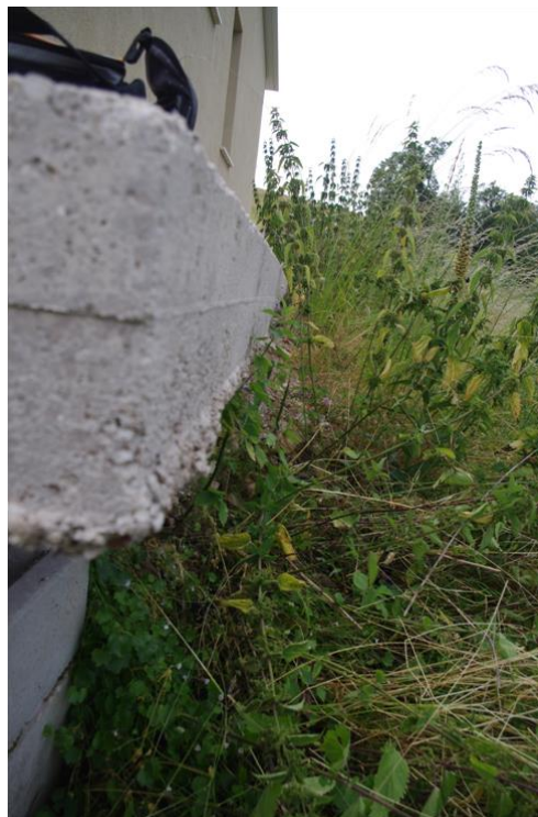
Foto 2 – Cedimenti lato Nord-Ovest
