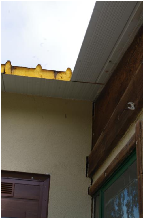
Foto 5 Collegamento tra “Edificio A” e “Edificio B” Quadro fessurativo coerente con i cedimenti differenziali del lato Nord-Ovest
