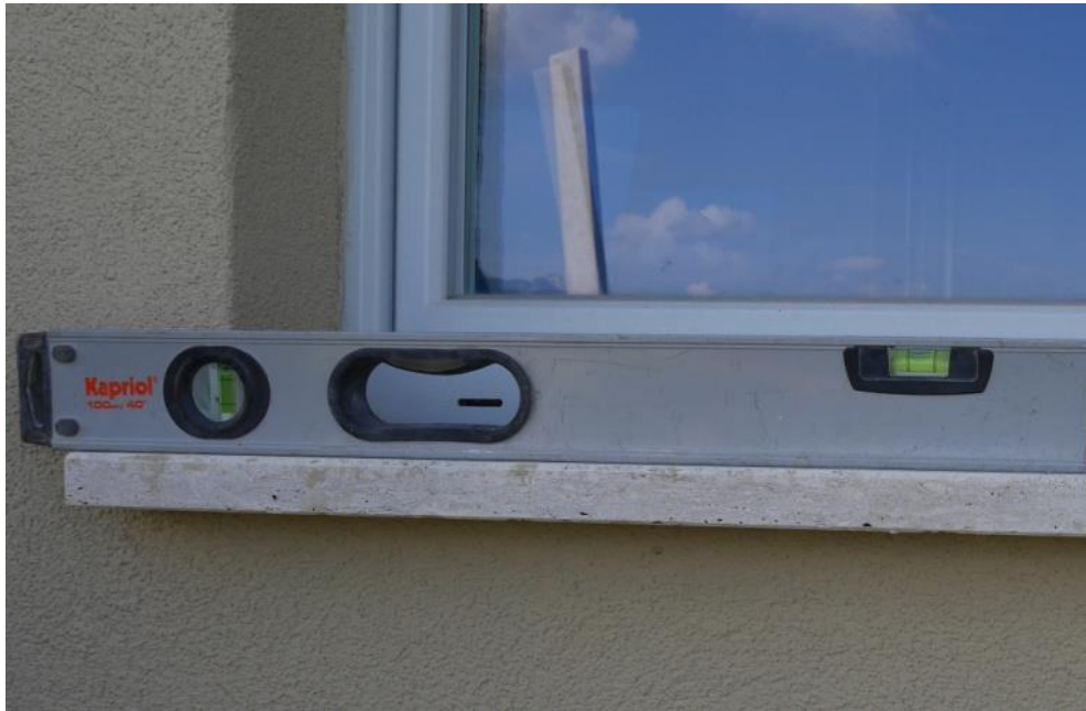
Foto 15 – Inclinazione del fabbricato con rotazione verso valle dello 0,45% Particolare bolla livella
