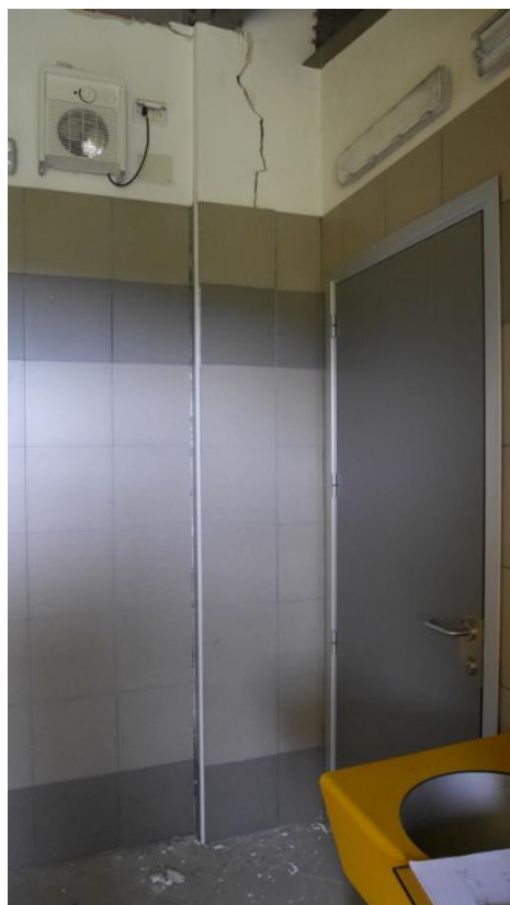
Foto 6 Collegamento tra “Edificio A” e “Edificio B” Quadro fessurativo in prossimità di ciò che dovrebbe essere un giunto - (A sinistra “Edificio A”)
