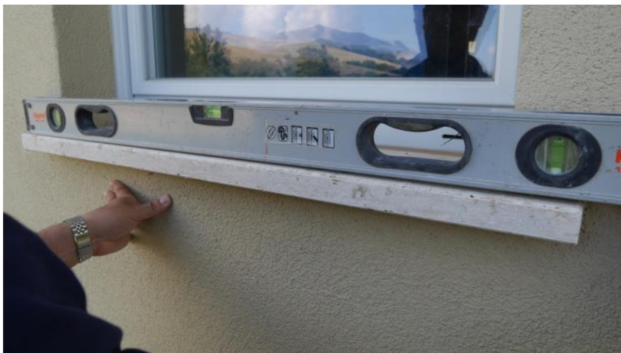
Foto 14 – Inclinazione del fabbricato con rotazione verso valle dello 0,45%
